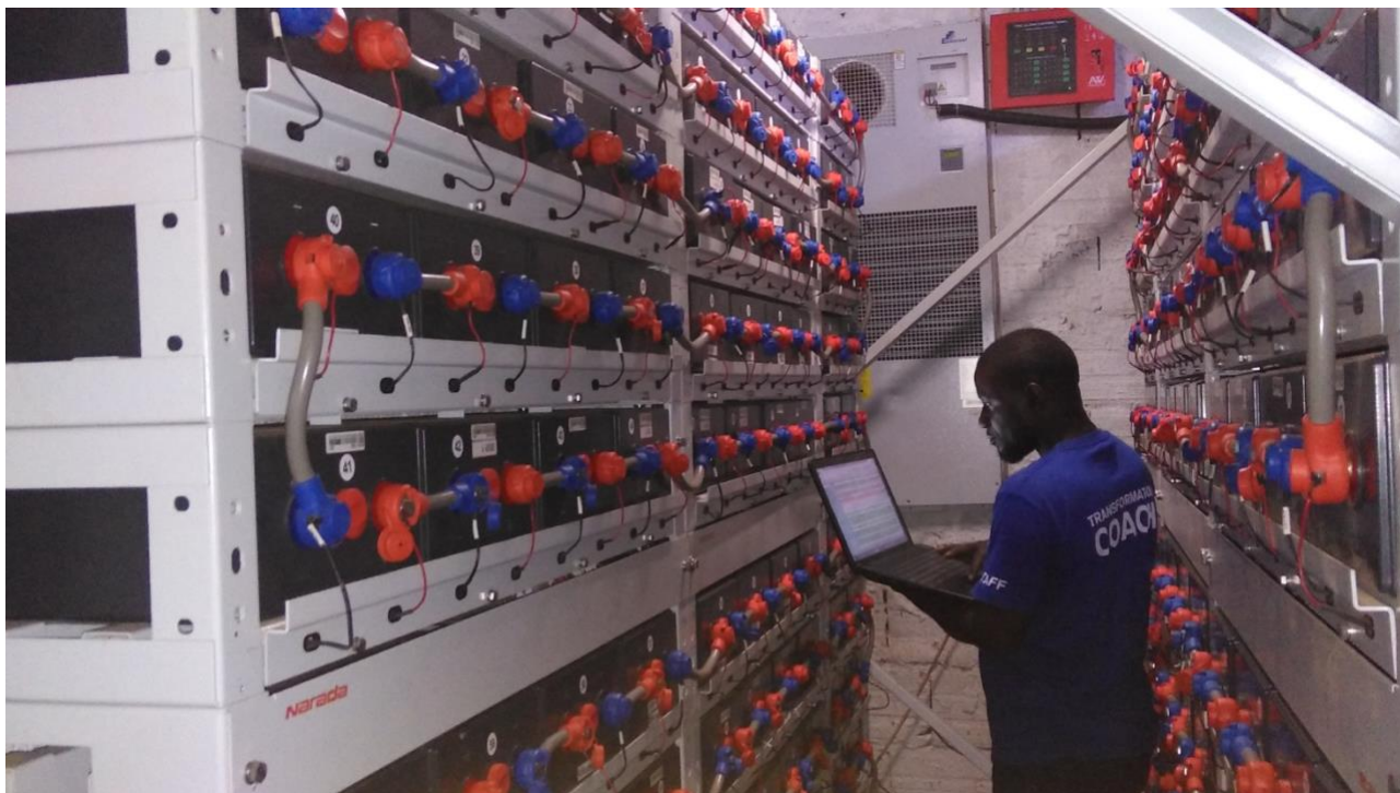
Immagine 4 – Tecnico al lavoro durante monitoraggio dell'impianto nel vano batterie
