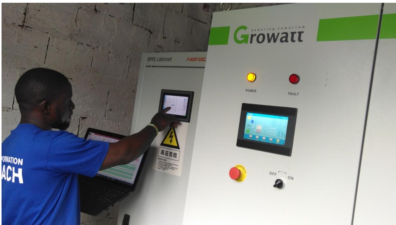
Immagine 5 – Tecnico al lavoro durante monitoraggio dell'impianto nel vano batterie ed inverter
